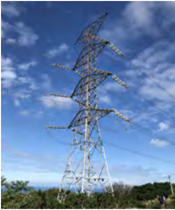
▲電塔 圖片提供 | 台灣電力公司
